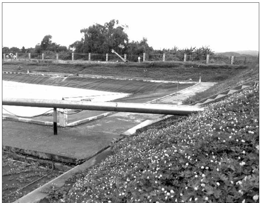
▲ Hệ thống xử lý nước thải của Nhà máy
