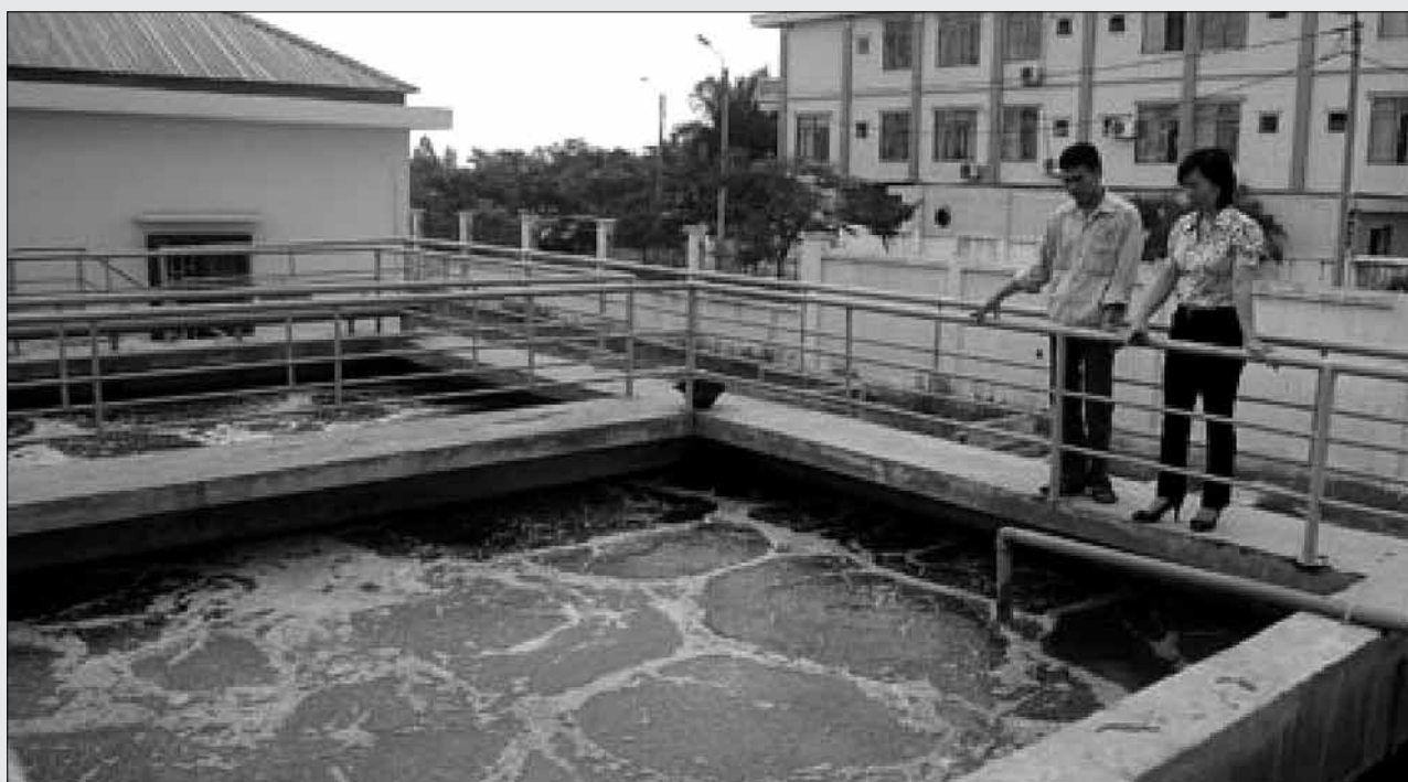
▲ Hệ thống xử lý nước thải tại Cụm công nghiệp Hà Bình Phương (Thường Tín - Hà Nội)
