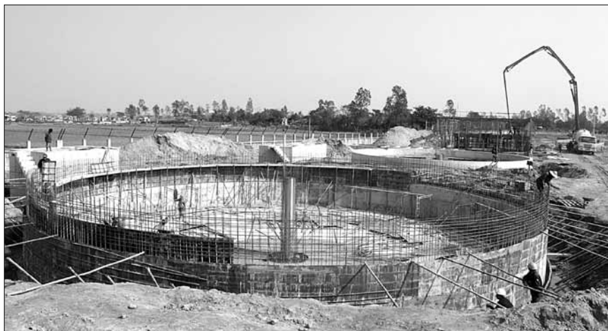
▲ Hệ thống xử lý nước thải tại KCN Bảo Minh đang được đầu tư xây dựng
